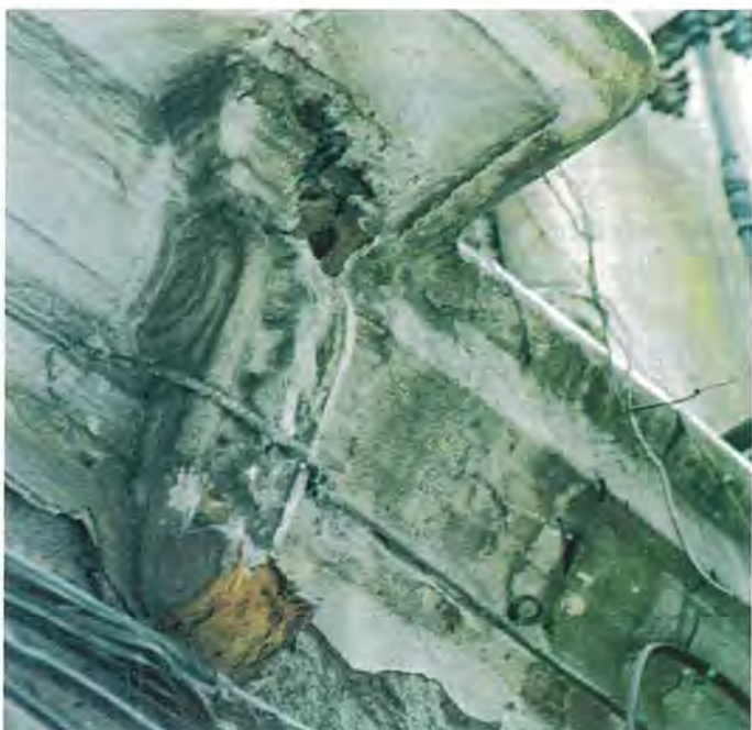
C. Císter, 15 LAS TERRACOTAS CON DEFECTOS DE COCCIÓN SÓLO ADMITEN LA SUSTITUCIÓN
