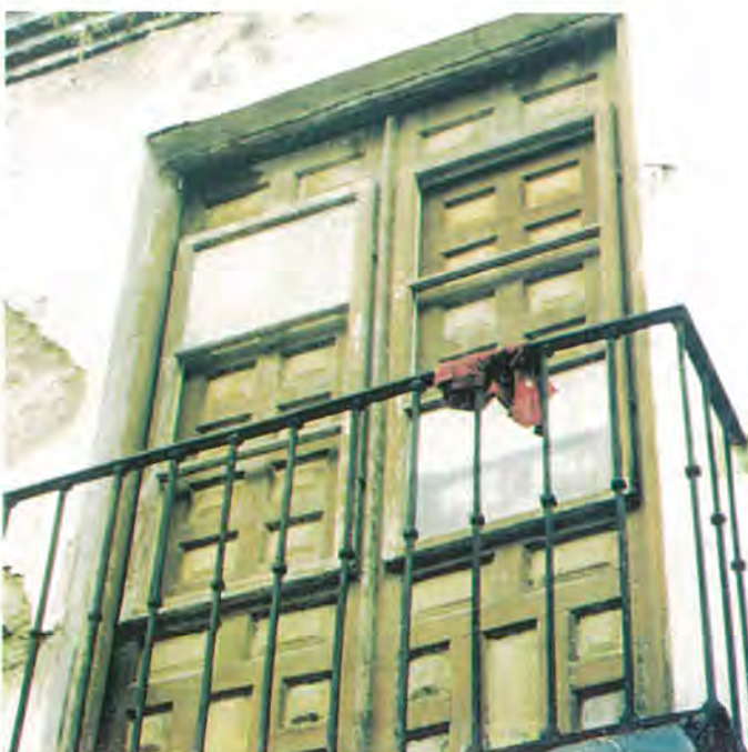
C. Nuño Gómez, 7/9. BALCONERA BARROCA DE CUARTERONES, POCO ACRISTALADA. LA RENOVACIÓN DE CARPINTERÍAS DEBE TENER EN CUENTA EL DISEÑO PROPIO DE CADA PERÍODO
