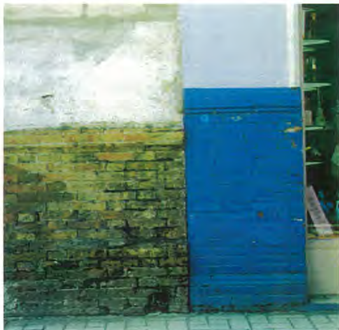
C. Gigantes, 10. LAS RESTAURACIONES DEBEN OCUPARSE TAMBIÉN DE DAR UN TRATAMIENTO CONVENIENTE A LOS ZÓCALOS ORIGINALES
