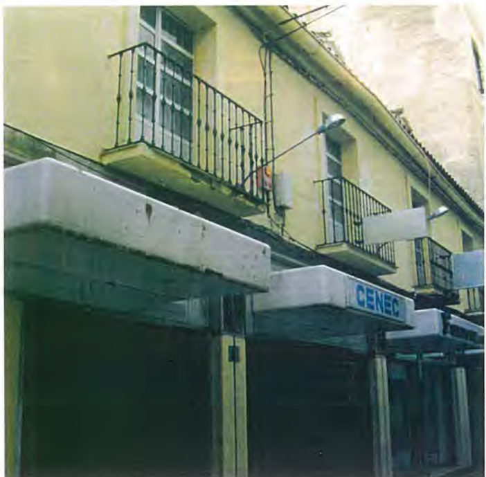
C. Hernán Ruiz, 4 PLANTA BAJA TOTALMENTE APEADA SIN RESPETAR LA CONCEPCIÓN ARQUITECTÓNICA PROPIA DEL EDIFICIO
