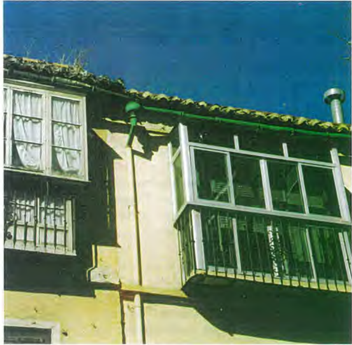
C. Carretería, 85 / 87. LA SUSTITUCIÓN DE LOS VIEJOS CIERROS DE MADERA POR NUEVOS ELEMENTOS DE CARPINTERÍA INDUSTRIALIZADA DEBE PROSCRIBIRSE TOTALMENTE
