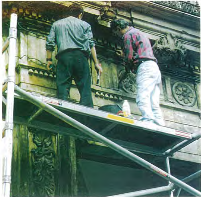
Av. Alameda LOS ANDAMIOS DEBEN CONTAR CON TODAS LAS MEDIDAS DE SEGURIDAD QUE MARCA LA LEGISLACIÓN VIGENTE
